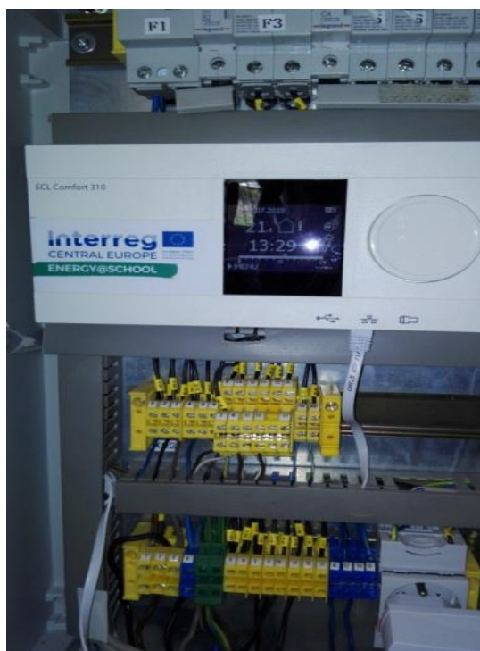
Hőellenőrző rendszer Bydgoszcz-ban, Lengyelországban
