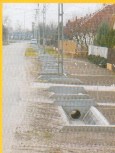
Belvíz elvezető csatorna
